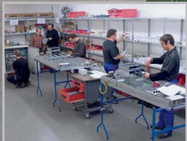
Steuerungs- und Schaltschrankbau im eigenen Hause
